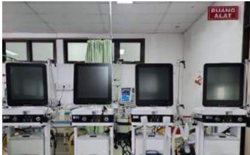
Gambar II. 13 Ventilator RSUD Merah Putih Kabupaten Magelang
